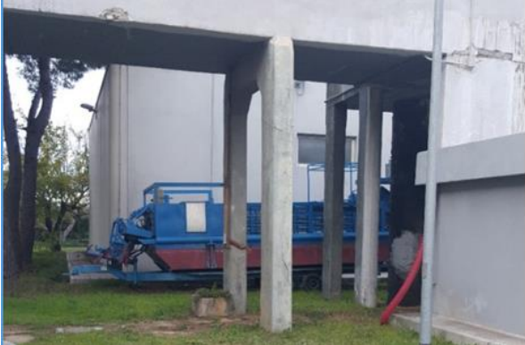
Foto 5 - Cavallotti ammalorati a sostegno canale pensile
