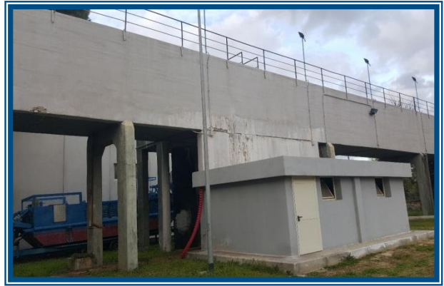
Foto 4 - Canale pensile con evidenza delle infiltrazioni di acqua
