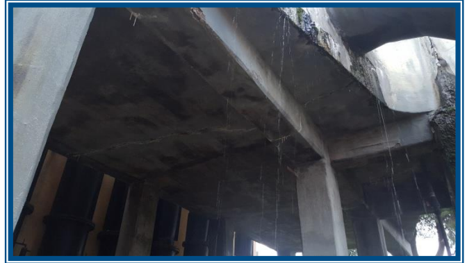
Foto 2 - Infiltrazioni, efflorescenze e venute d'acqua della vasca pensile
