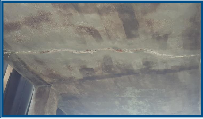
Foto 3 - Lesioni nelle strutture in cls
