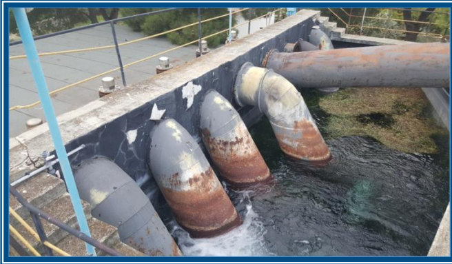
Foto 1 - Vasca pensile con distacchi della protezione passiva applicata
