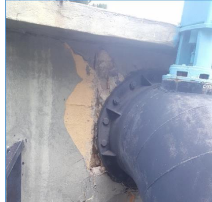
Foto 6 - Elementi in calcestruzzo da ripristinare
