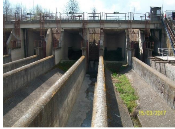
Foto 2 - Opera di presa e paratoie da rifunzionalizzare
